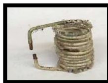
Foto 7. Bobina sin aislamiento.
